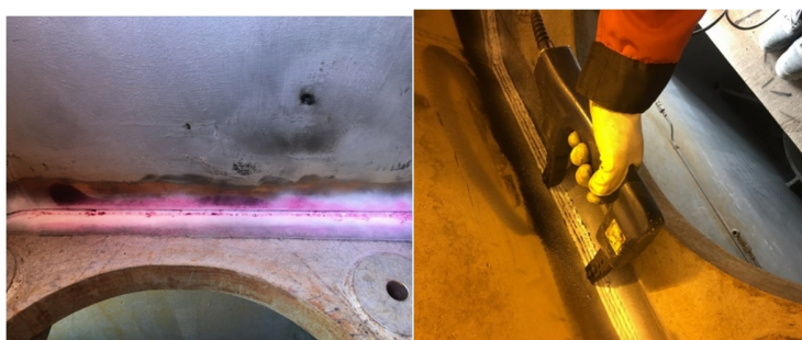
شکل 3- انجام آزمون مایع نافذ برای پاس ریشه و سپس آزمون ذرات مغناطیسی در اتمام عملیات جوشکاری.
