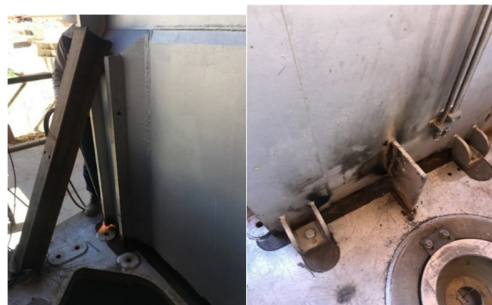
شکل 1- فیکس شدن قطعه کار توسط تک زنی لچکی‌ها و ساپورت‌ها جهت شروع جوشکاری.
